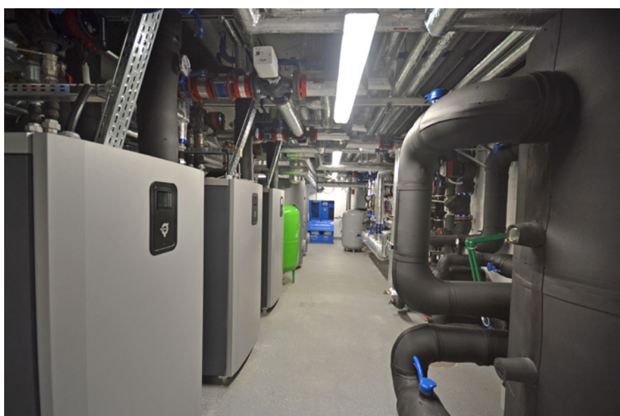
Siłownia z gruntowymi pompami ciepła Mega marki Thermia
